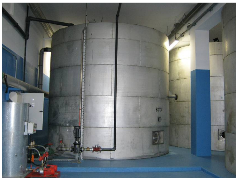
Réservoirs de la centrale
