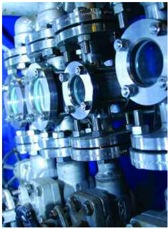
Hublots de contrôle de la turbine
