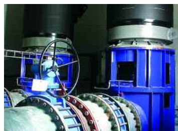
Les pompes d'eau de mer
