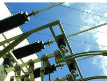
Vers le réseau électrique
