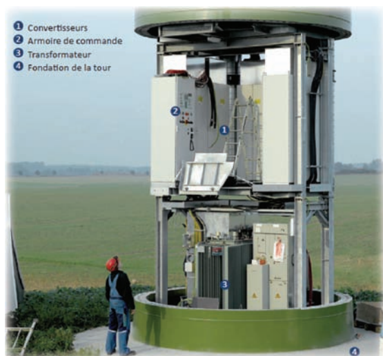
Source SER-FEE - © ENERCON Vestas Wind Systems A/S Composants électroniques dans le mât d'une éolienne
